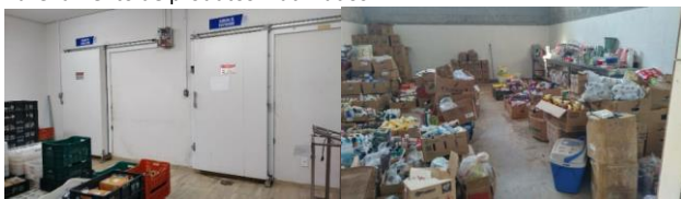
Figura 16: a) Parte externa das câmaras frigoríficas; b) local de armazenamento de produtos inutilizados.
