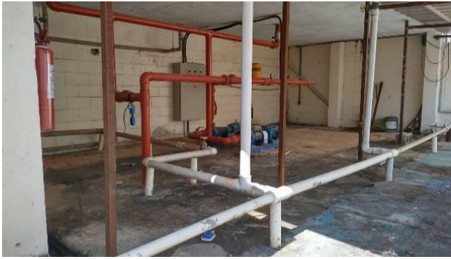
Figura 12: Estrutura hidráulica do poço artesiano.
