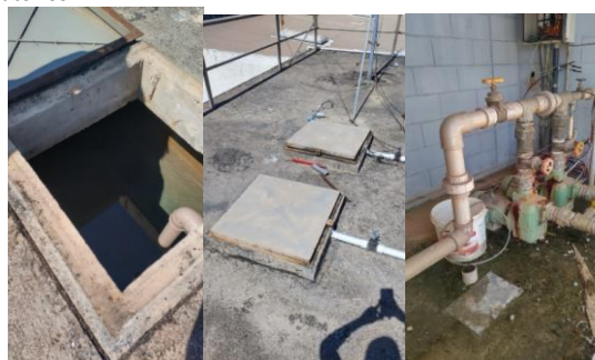
Figura 11: a) Sistema de abastecimento de água, b) estrutura externa dos reservatórios.
