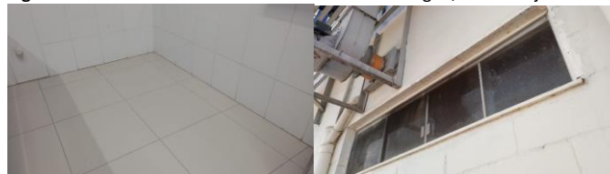
Figura 6: Piso sem arredondamento e caimento de água; telas das janelas.
