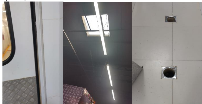
Figura 10: a) Borracha de vedação das portas; b) telas na ventilação do teto; c) condições estruturais dos ralos.
